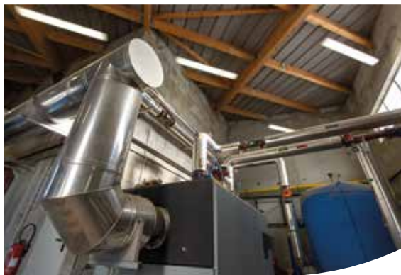
CHAUFFERIE BOIS DU PUIT
